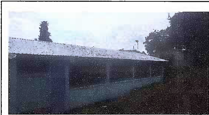
Foto 17: CULMINACIÓN DEL CAMBIO DE TECHO EN EL MODULO 3 DEL CENTRO EDUCATIVO EORM CANTÓN CHUISIGUAN.
