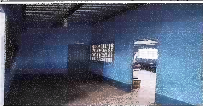
Foto 21: FINALIZADA LA APLICACIÓN DE PINTURA EN EL CORREDOR DEL MODULO 3 DEL CENTRO EDUCATIVO EORM CANTÓN CHUISIGUAN.
