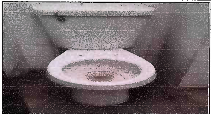
Foto 2: Estado de sanitario antes de sustitución
