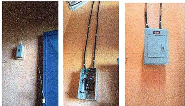
Foto 7: modulo II, Susntitucion de tablero de flipones e istalacion de tablero de flipones, sustitucion e instalaciones flipones.
