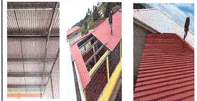
Foto 4: modulo I, Cubierta de Lamina Sustitucion de lamina por lamina troquelada aluzinc calibre 26, elementos de fijación (tornillos), desinstalacion e instalación.
