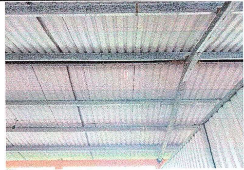
Foto 4: modulo I, Cubierta de Lamina Sustitucion de lamina por lamina troquelada aluzinc calibre 26, elementos de fijación (tornillos), desinstalacion e instalación.
