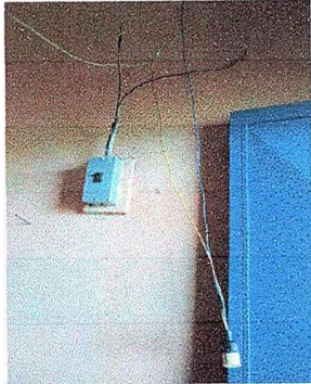
Foto 7: modulo II, Susntitucion de tablero de flipones e istalacion de tablero de flipones, sustitucion e instalaciones flipones.
