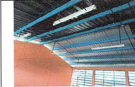
Foto 19: modulo III, Reparacion de cableado electrico, sustitucion de ducto electrico mas accesorios, sustitucion de lamparas led e instalacion de unidades de luz.
