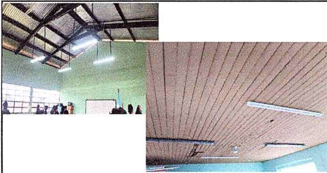
Foto 3: Sustitución de lamparas LED.
