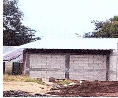
Foto 2: MODULO 1. Sustitución de lamina y sustitución de estructura de soporte de madera por metal
