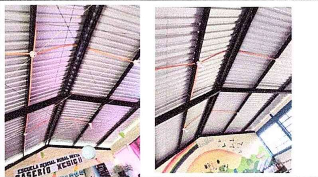
Foto 4: MODULO 2. Sustitución de lamparas LED, quinto B y quinto B
