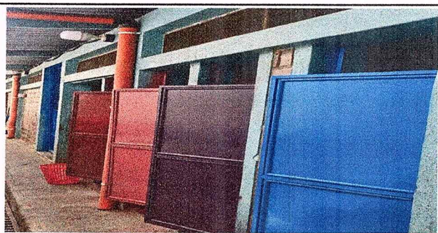
Foto 5: MODULO 1 MANTENIMIENTO DE 7 PUERTAS DE BAÑOS SANITARIOS. Lijado cepillado, aplicación de pintura.
