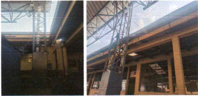
Mantenimiento de bases estructurales de columnas de techo del patio con Pintura
