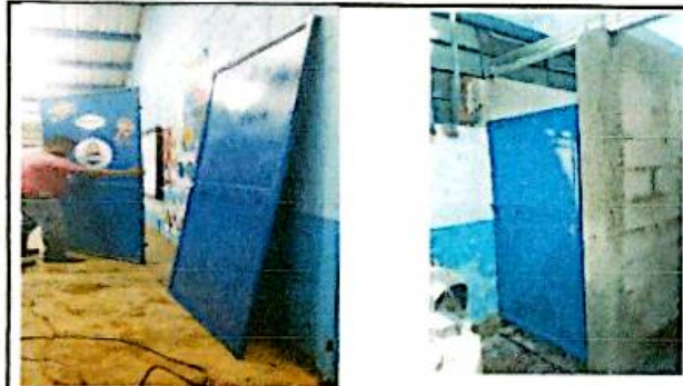
FOTO 15: SUSTITUCION DE 1 PUERTA DE METAL EN AULA Y SUSTITUCION DE 2 PUERTAS DE METAL EN SANITARIOS
