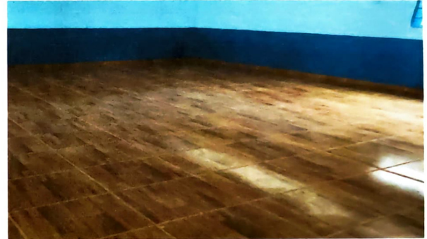
Foto 10: SUSTITUCIÓN DE PISO DE CONCRETO POR PISO CERÁMICO CON BASE DE CONCRETO, módulo 4
