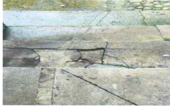
ESTADO EN QUE SE EENCUESTRAN LAS GRADAS DE ACCESO
