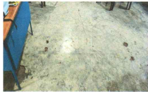
ESTADO EN QUE SE ENCUENTRA EL PISO DEL MODULO 04
