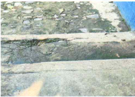
ESTADO EN QUE SE EENCUESTRAN LAS GRADAS DE ACCESO
