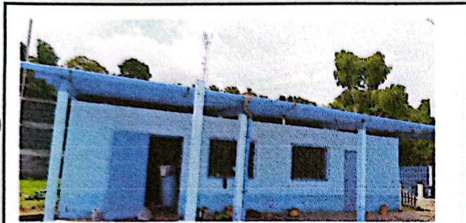
Foto 19: Suministro e instalación de canal de bajada pluvial en dos aulas en uso durante lluvia
