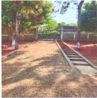
REPARACIÓN DE RAMAPA DE INGRESO, INSTALACIÓN DE TORTA DE CONCRETO Y EMPEDRADO
