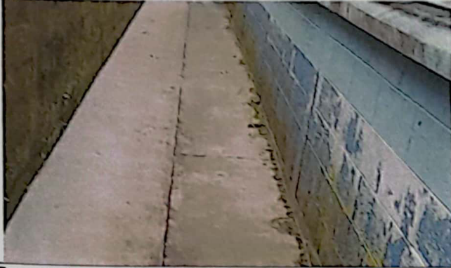
Banqueta de protección módulo 1
