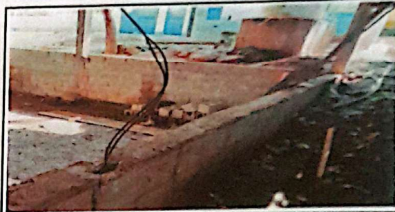
Suministro y reparacion de muros exteriores e interiores en modulo de cocina y aulas.
