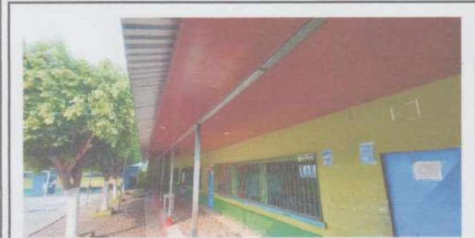
Foto1: VISTA SUSTITUCIÓN DE MACHIMBRE POR CIELO DE PVC Y SUMINISTRO DE ENERGÍA ELECTRICA E INSTALACIÓN DE LAMPARAS OJO DE BUEY FINALIZADO
