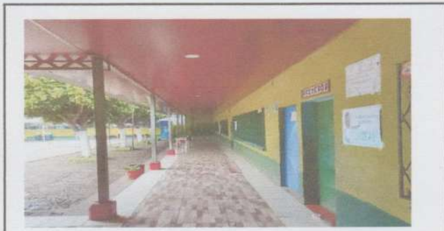
Foto 4: VISTA SUSTITUCIÓN DE MACHIMBRE POR CIELO DE PVC Y SUMINISTRO DE ENERGÍA ELECTRICA E INSTALACIÓN DE LAMPARAS OJO DE BUEY FINALIZADO
