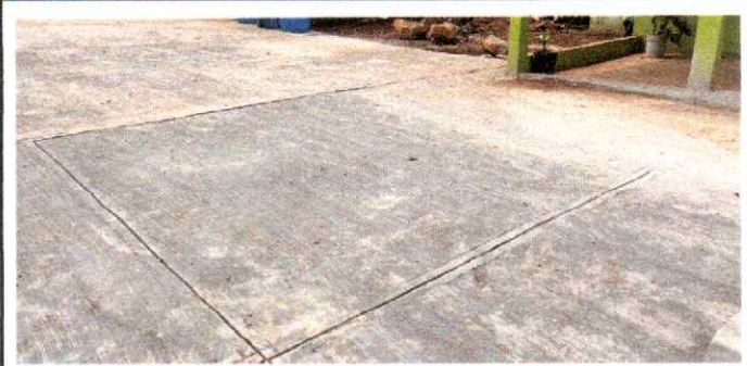
Foto 10: Se puede verificar el mejoramiento de piso de torta de concreto en patio.
