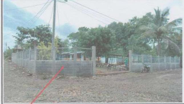
Suministro y sustitución de muro perimetral de block con tubo hg y malla galvanizada, soleras intermedias y columnas.
