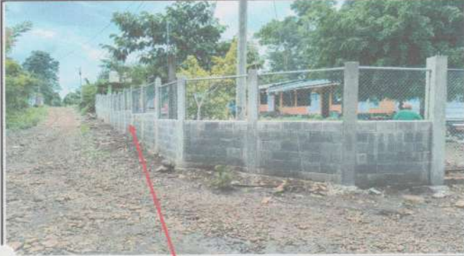
Suministro y sustitución de muro perimetral de block con tubo hg y malla galvanizada, soleras intermedias y columnas.
