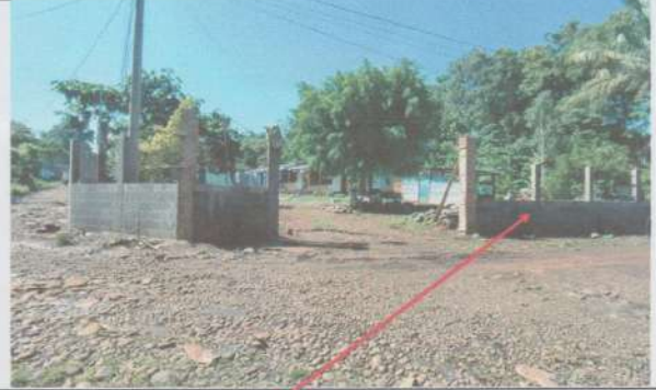
Suministro y sustitución de muro perimetral de block con tubo hg y malla galvanizada, soleras intermedias y columnas.
