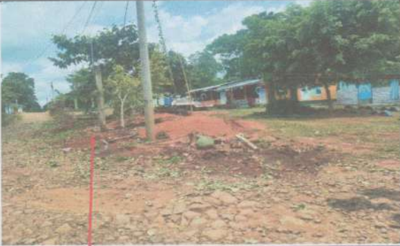
Suministro y sustitución de muro perimetral de block con tubo hg y malla galvanizada, soleras intermedias y columnas.
