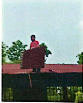
Foto 1: SEMONTAJE DE LAMINA EN MAL ESTADO
