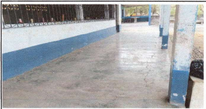
Foto 3: Estado de piso en corredor de módulo 1.
