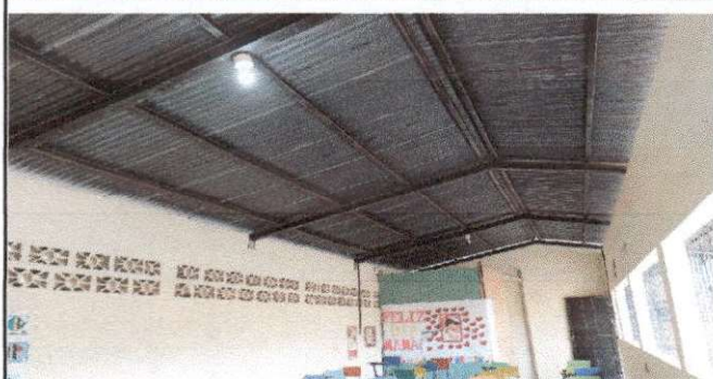
Foto 7: Estado de techo e iluminación en interior de aula en módulo 2.
