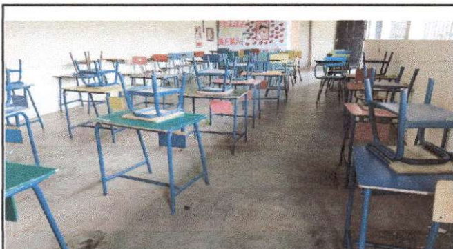
Foto 9: Estado de piso en aula de módulo 2.
