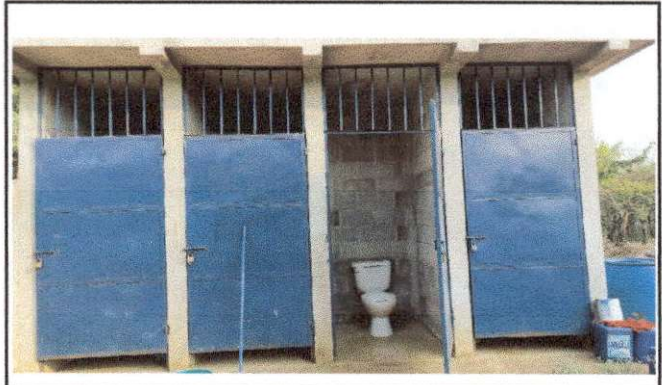
Foto 2: Estado físico de modulo de sanitarios.
