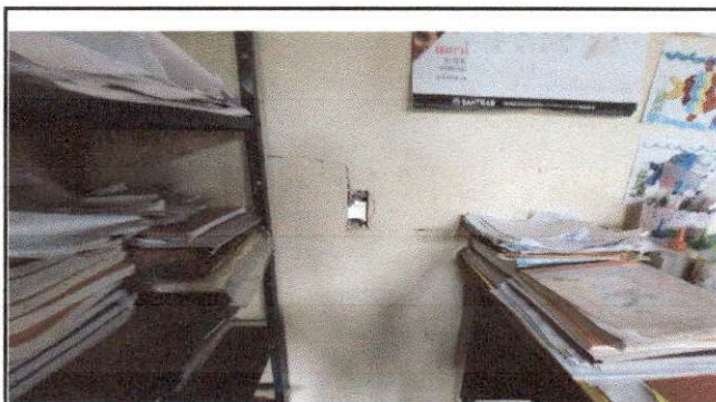
Foto 10: Falta de instalaciones electricas en aulas de módulo 2.
