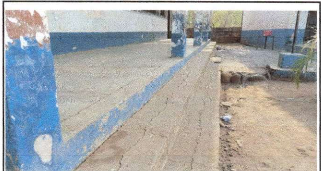
Foto 6: Estado de piso y banqueta en módulo 2.
