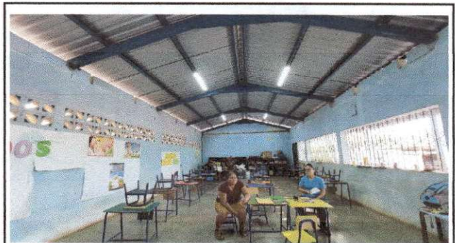
Foto 4: estado del interior de aula en módulo 1.
