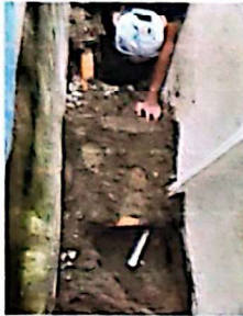
Foto 7: Mantenimiento Fosa Séptica
