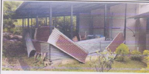
Mejoramiento de cubiertas con Block y Ventanas, para mejorar la entilación de los estudiantes
