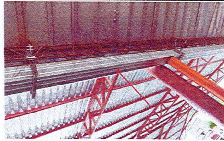
Foto 2: SUMINISTRO DE CANALES
