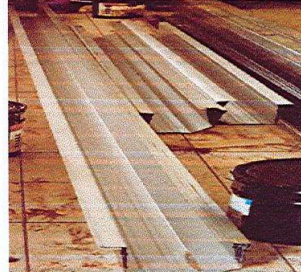
Foto 2: SUMINISTRO DE CANALES
