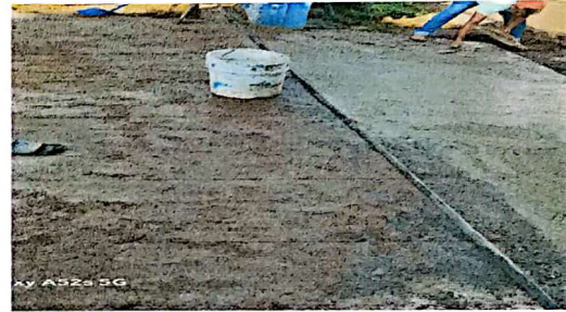
suministro e instalación de torta de concreto para piso de aula 92 mts2
