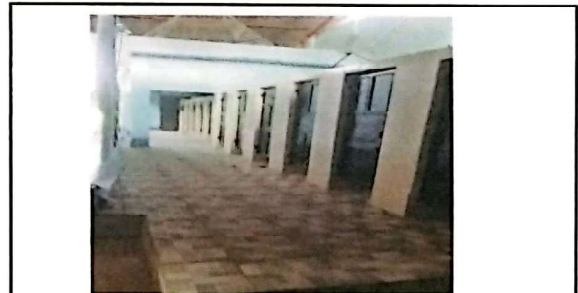
MANTENIMIENTO DE MUROS DE TABIQUE DE "14" CABINAS DE SANITARIOS MODULO 1 Y MANTENIMIENTO DE "14" PUERTAS METALICAS DE CABINA DE SANITARIOS MODULO 1
