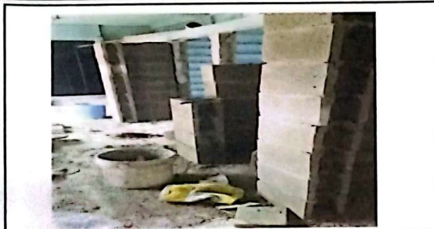
MANTENIMIENTO DE MUROS TABIQUE DE "14" CABINAS DE SANITARIOS MODULO 1 Y MANTENIMIENTO DE "14" PUERTAS METALICAS DE CABINA DE SANITARIOS MODULO 1
