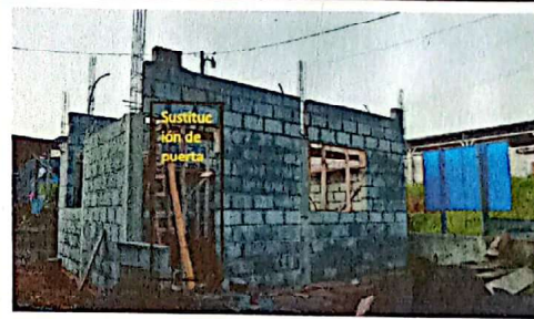
Foto 4: Sustrucción de puerta
