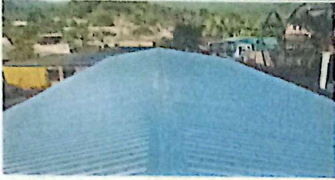
Mantenimiento sustitucion estructura de madera por estructura metalica galvanizada. Mantenimiento sustitucion de cubierta de lámina C26
