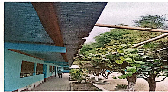
Suministro de lámina acanalada calibre 24, vigas metálicas, corredor del modulo de aulas.
