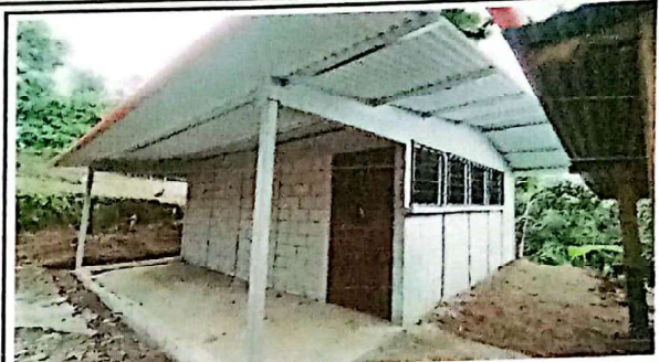
Suministro e instalación de estructura para techo con techo de lamina troquelada/acanalada aluzinc cal 26, Suministro e Instalacion de puerta de metal con chapa Yale 1x2.5 m.
