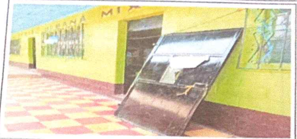
Foto 2: REMOSAMIENTO DE PUERTAS Y VENTANAS EN MAL ESTADO.
