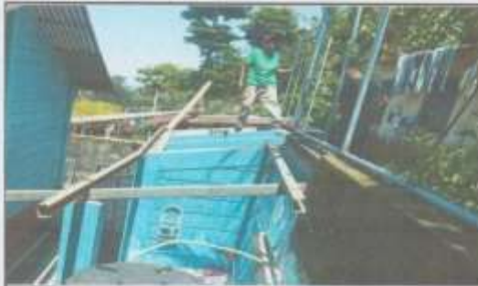
Foto 9: Suministro e instalación de malla y tubo galvanizado en pared existente en módulo 2.
