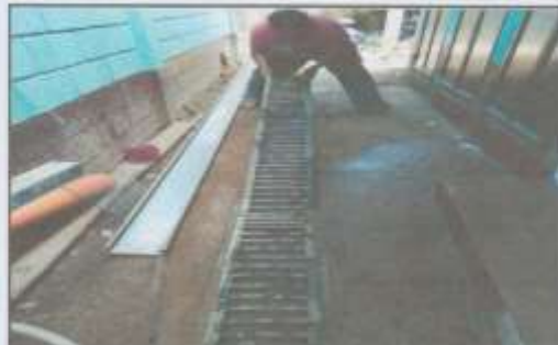
Foto 4: Suministro e instalación de rejilla pluvial en sanitarios y frente a gradas de módulo 2
