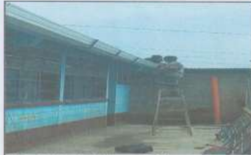
Foto 2: Suministro e instalación de canal de PVC con bajada de agua pluvial en módulo 2
