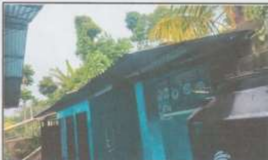
Foto 3: Suministro e instalación de canal de PVC con bajada de agua pluvial en sanitarios
