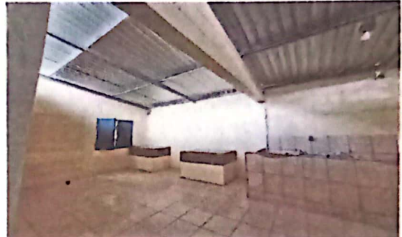
Foto 2: VISTA DE ESTUFAS Y PILA DENTRO DE LA COCINA
