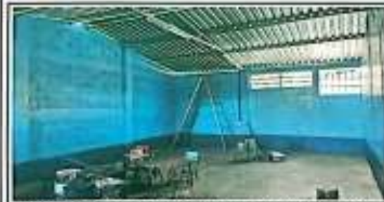
Foto 5: SUMINISTRO E INSTALACIÓN DE ORIENTACIÓN, SUMINISTRO E INSTALACIÓN DE BUREOS Y ESTRUCTURAS, SUMINISTRO E INSTALACIÓN DE ESTRUCTURA DE TECHO METÁLICO EN EL AULA
