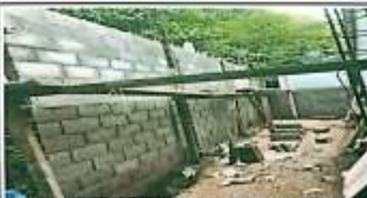
Foto 5: SUMINISTRO E INSTALACION DE CIMENTACION, SUMINISTRO E INSTALACION DE MURDYS ESTRUCTURAS, SUMINISTRO E INSTALACION DE ESTRUCTURA DE TECHO METALICO EN EL AREA
