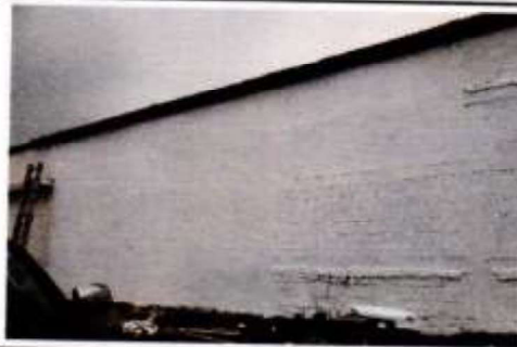
Suministro, trabajo en 79 mts2: limpieza y aplicación de impermeabilizante para exterior parte trasera de 2 aulas
