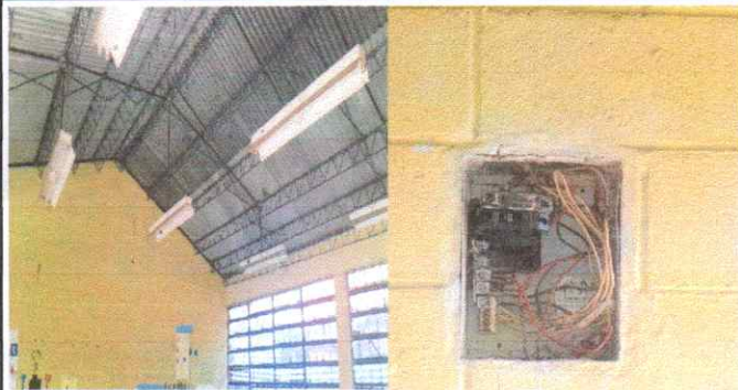
Mantenimiento de sistema electrico general
