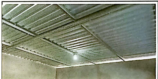
Foto 4: VISTA DE INSTALACION ELECTRICA ILUMINACION Y FUERZA
