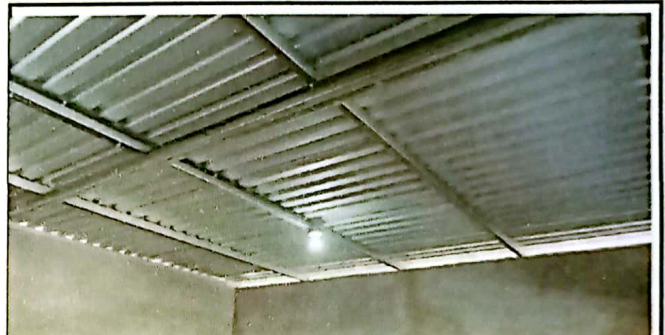
Foto 4: VISTA DE INSTALACION ELECTRICA ILUMINACION Y FUERZA
