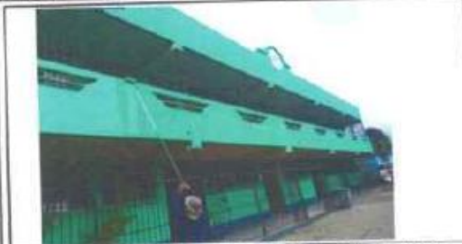
Proceso de aplicación de pintura en el exterior de la escuela con el color verde colonial
