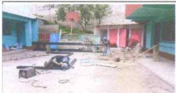
Foto 2: Instalación de torre de estructura para tanque de agua potable + instalación de tubería.
