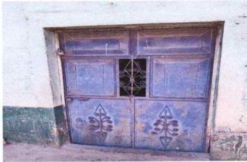
Mantenimiento de puerta (lijado, cambio de tubo, aplicación de dos manos de pintura anticorrosiva) de color negro, tubo de 1"1 chapa de 18
