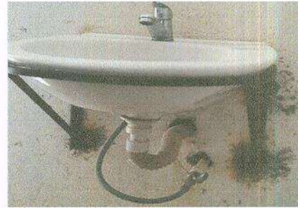
Mantenimiento de lavatrastos
