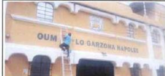
Foto 6: sustitución de letrero de nombre del establecimiento
