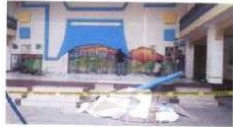
retiro de material tablayeso, en época de lluvia filtración en el muro por lo que se deteriora el material
