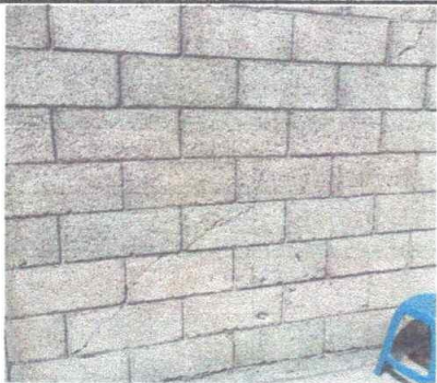
Foto 3: Muro dañado por fuerza cortante, área donde se realizará la reparación con block, columna y solera
