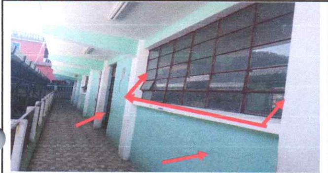
sustitución de chapa, sustitución de balcones, sustitución y aplicación de pintura en muros.
