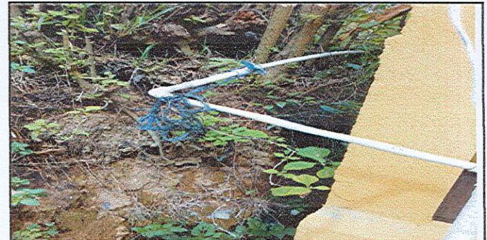
12. Cambio de tubería PVC para línea de distribución de agua potable de 1/2 pugada
